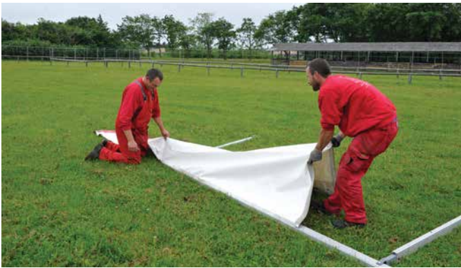
Ved at montere gavlduge, mens teltet ligger ned, sparer man brug af stige og undgår arbejde over hovedhøjde. Der skal to personer til at montere gavlstykker. Derved kan dugen rettes til, så den let passerer igennem notgangen. På den måde reduceres trækbehovet.
