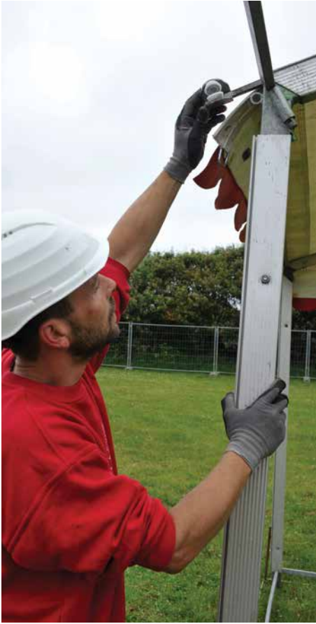
Styrerullen placeres i gangen på tagspærret. Derved skal der bruges færre kræfter til at trække tagdugen over.
