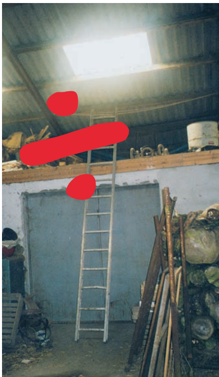
▲ Figur 5.11 Til venstre en gammel alustige uden afstivning eller fastgørelse. Til højre et eksempel på fast stige og rækværk såvel på loftet som omkring stigen afslutning.
