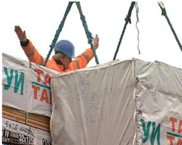
Usikker stakning/sikring af last
