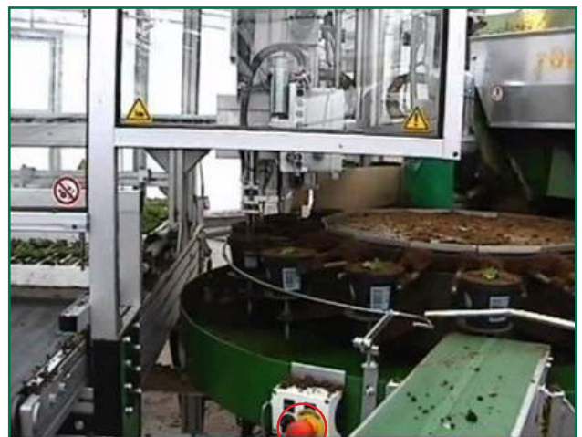
Eksempel på afskærmning samt skiltning af priklerobottens arbejdsområde ved pottemaskine. Bemærk nødstop nederst i midten.
